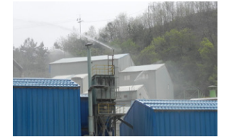
설비 상부 살수시설
